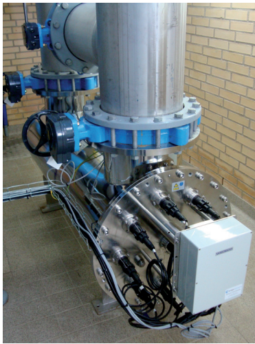
Figur 20.15. UV-anlæg på Skagen Vandværk II.
